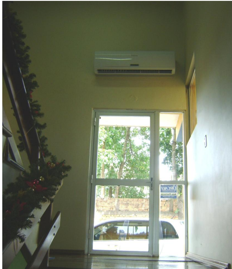
Climatização do ambiente central
