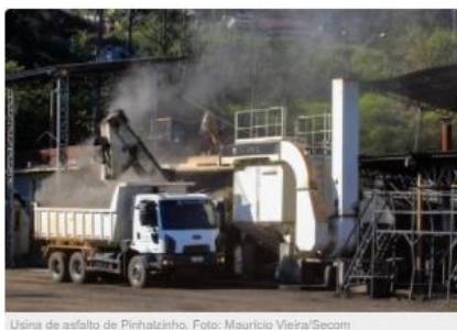
Usina de asfalto de Pinhalzinho. Foto: Mauricio Vieira/Secom
